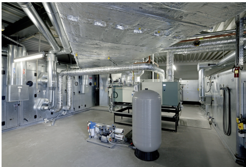
3. ábra: A „Condair GS” gőz-légpárástó berendezés (előtér) és a belső légtechnikai berendezés frisslevegő része a Kronberg Campusban (a háttér bal oldalán).
